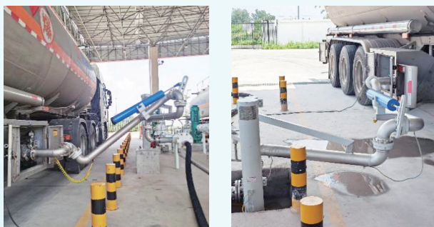
图2 错误安装收油鹤管
