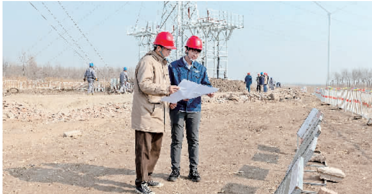
国网天津滨海公司在津潍高铁天津段电力迁改项目——35千伏西沙、西平线路迁改工程日前正式投产送电。项目建成后,将串联京津冀与山东半岛城市群,对推动环渤海经济圈协同发展、服务“双碳”战略具有重要意义。图为技术班组正在检查线路图。 沈岳 摄
